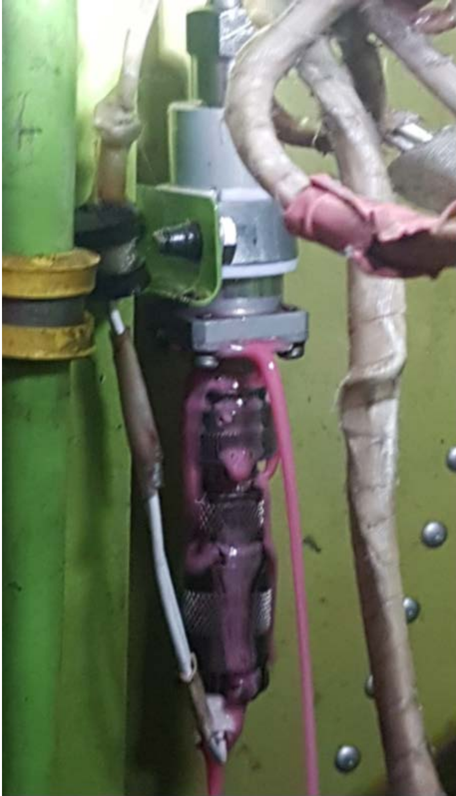
Photo no 1 – Fuite du S9 du manocontact basse pression
