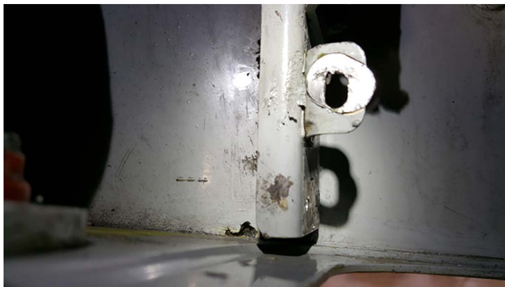
Figure 1 – Vue de la corrosion avant la réparation
