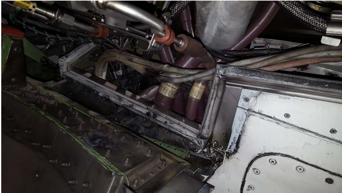
Photo 1 : RJ900 – Emplacement de la nacelle où les câbles frottent contre les pièces de fixation du panneau
