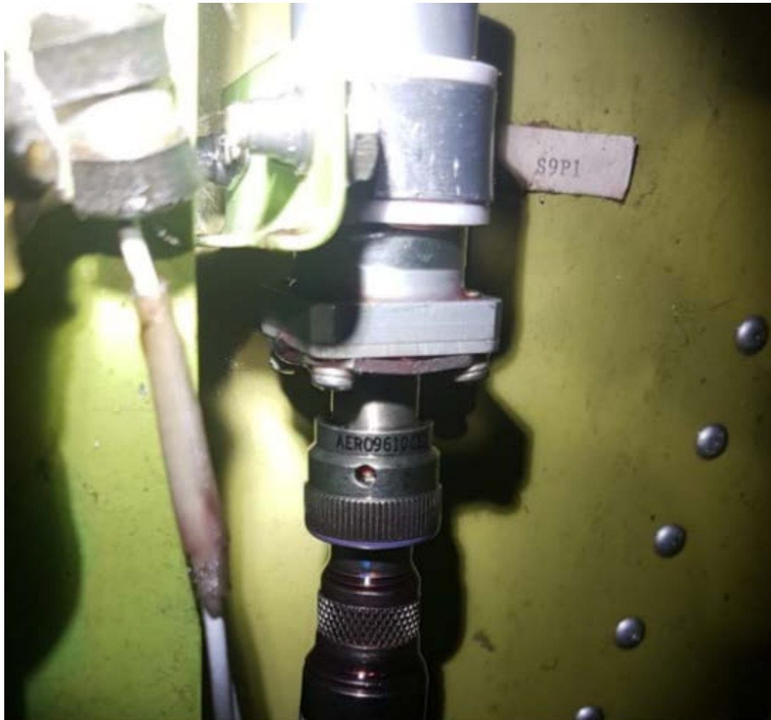
Photo no 2 – Gonflement dans le corps de raccord et joint torique subséquent faisant saillie
